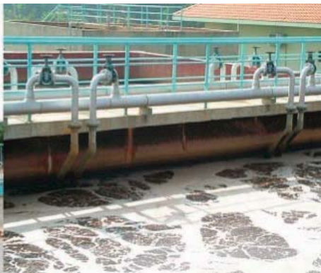
Hình ảnh trạm xử lý nước thải KCN Lê Minh Xuân
