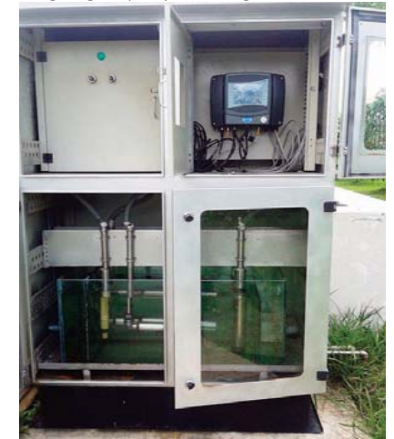
Hệ thống trạm quan trắc tự động
